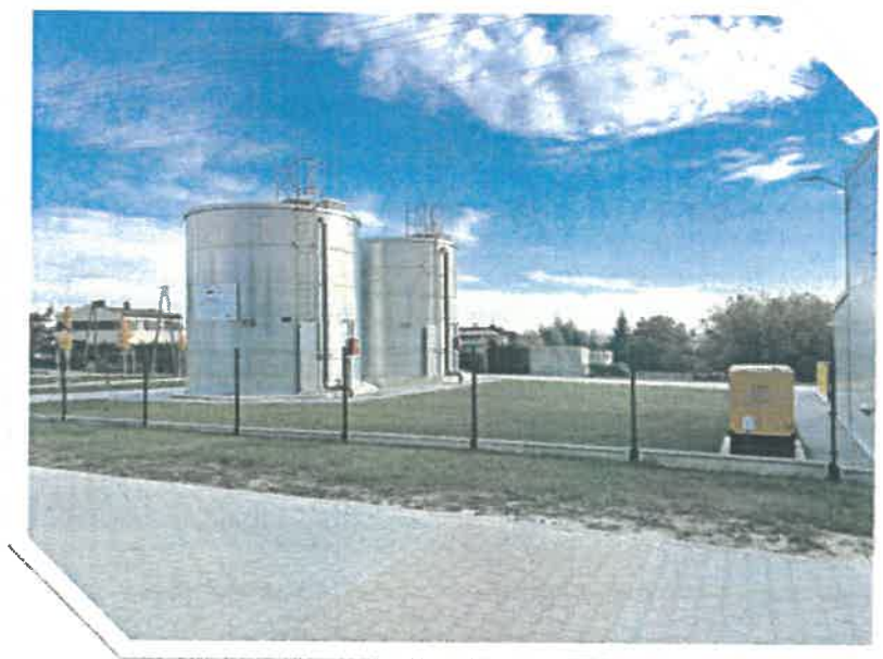
Stacja uzdatniania wody
